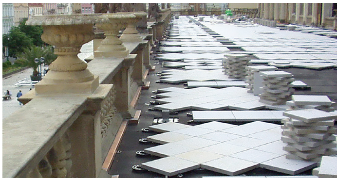
Mlýnská kolonáda , Karlovy Vary – projektová dokumentace a autorský dozor rekonstrukce izolačního souvrství terasy s vysokou spolehlivostí (dvojitý hydroizolační systém).
