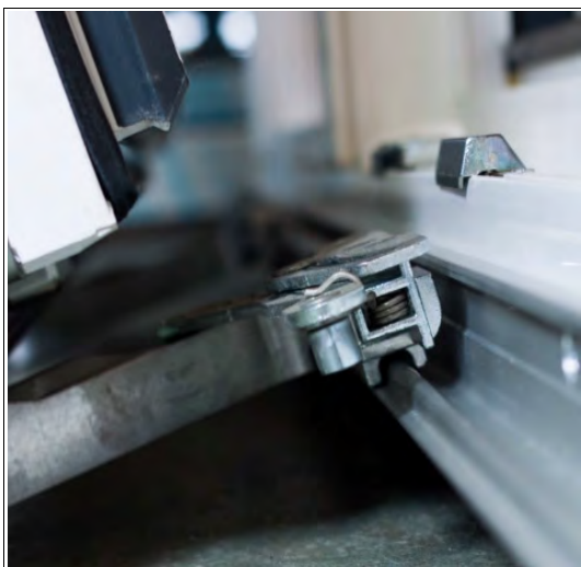
Foto 47 – uvolněná kolejnice spodního pojezdu po naklonění křídla
