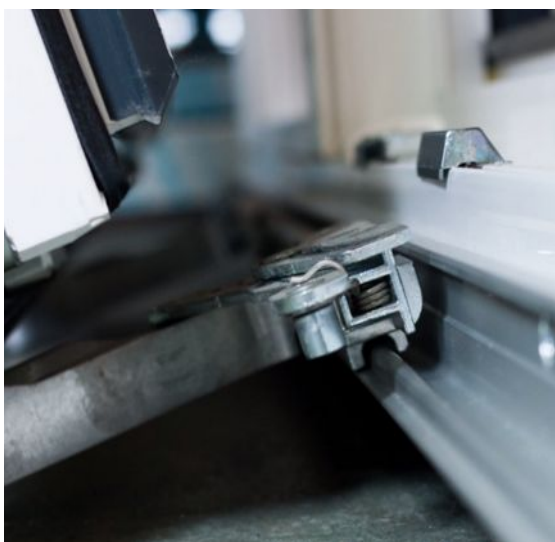
Obr. 58 – Uvolněná kolejnice spodního pojezdu po naklonění křídla
