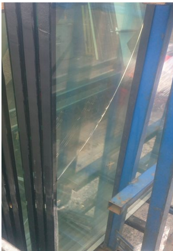
Obr. 20 – Poškozené zasklení okna na přepravní konstrukci
