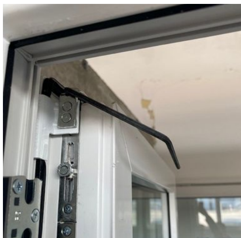
Obr. 71 – Vodorovný posun horní části křídla
